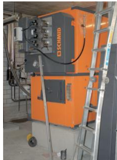
Eine mächtige Anlage: Die neue Heizung verbrennt ausschliesslich Holz aus der Schreinerei und den eigenen Wäldern.
