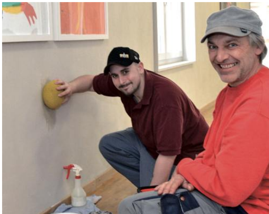
Markus V. gefällt die Arbeit bei Unterhalt & Reinigung. Ganz zur Zufriedenheit von Andreas Köchli flickt er schadhafte Stellen in den Lehmwänden des Neubaus.
